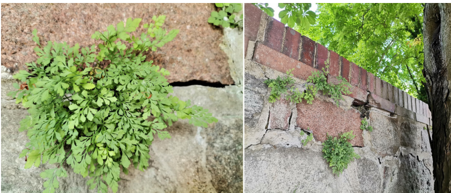
Abb. 8: Kräftige Büschel der Mauerraute ( Asplenium ruta-muraria ) an Außenmauer des Ehrenmals, 04.07.2022
