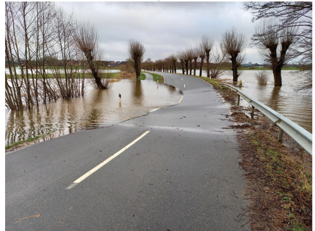
Abb. 153 Überschwemmungen auf der Kreisstraße nach Rümpel (UG 21.02.2022)
